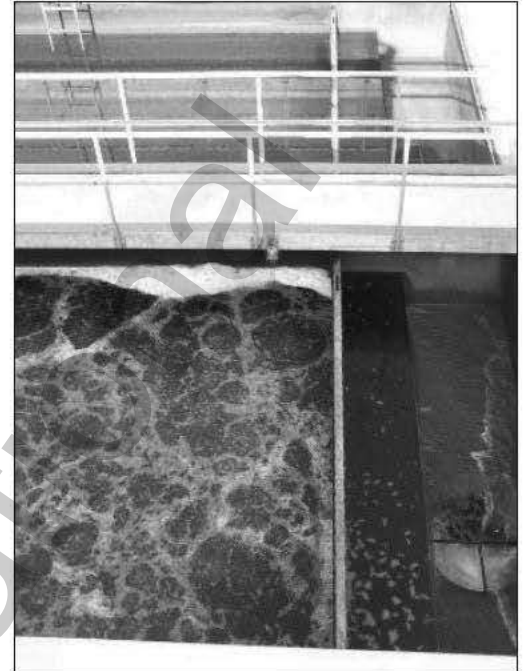
Sortie eau traitée d'un Biofor STEP DE NYON
